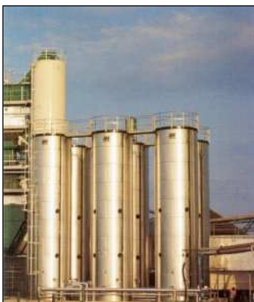
Fig. 1 - Cisterne deposito bitumi e olio combustibile
