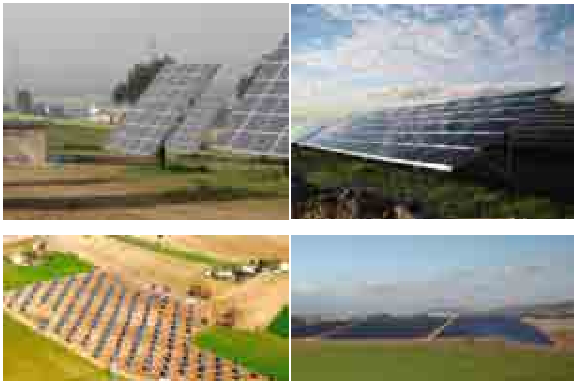
Figura 1: Confronto visivo fra impianti fotovoltaici a terra fissi e con sistemi di movimento
