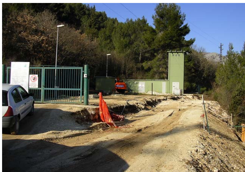
Foto 1 – Campo pozzi S. Rocco, sono visibili cabina elettrica, l'illuminazione e la recinzione
